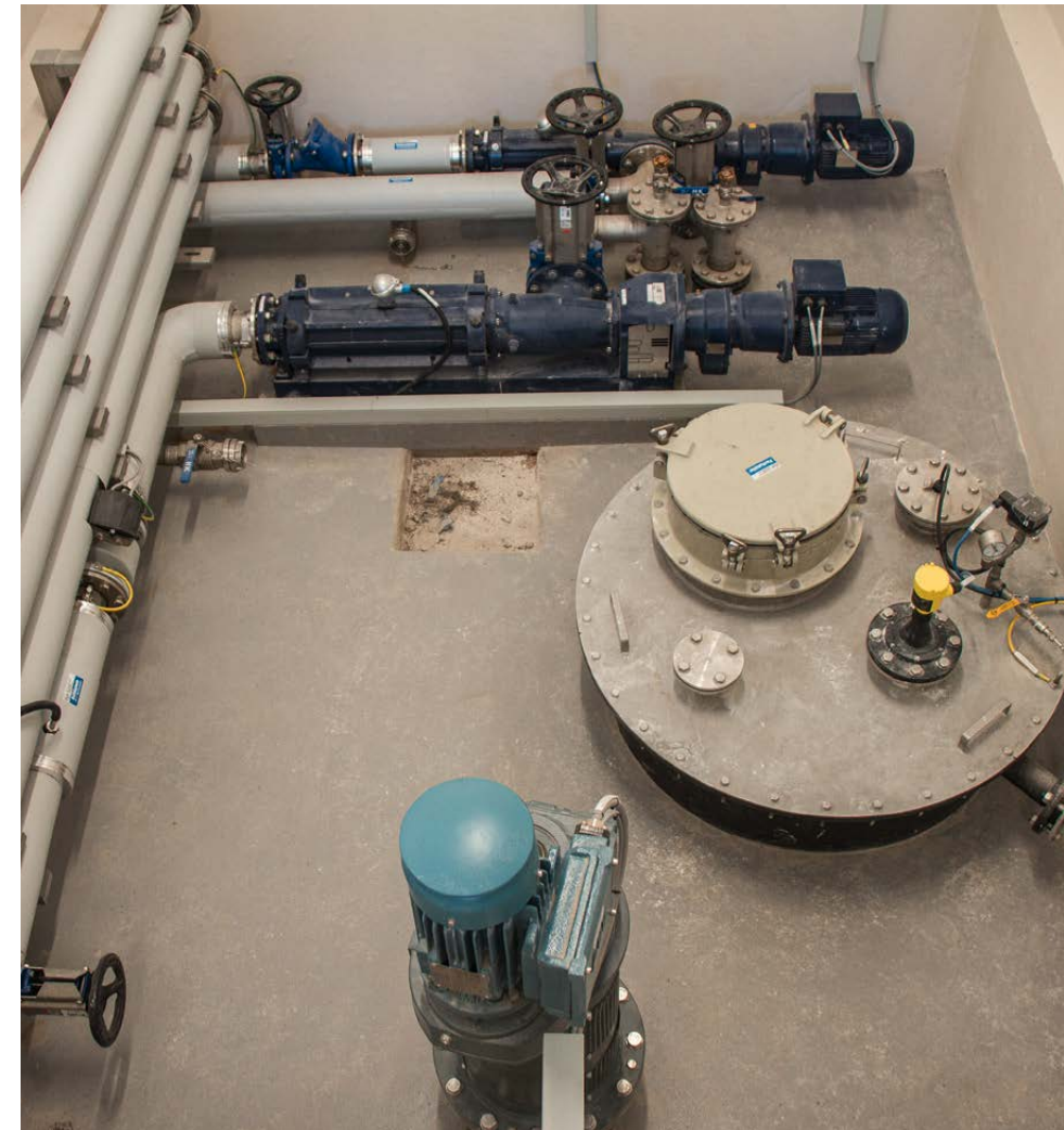
Rührwerk und Wärmetauscher von Faulbehälter
